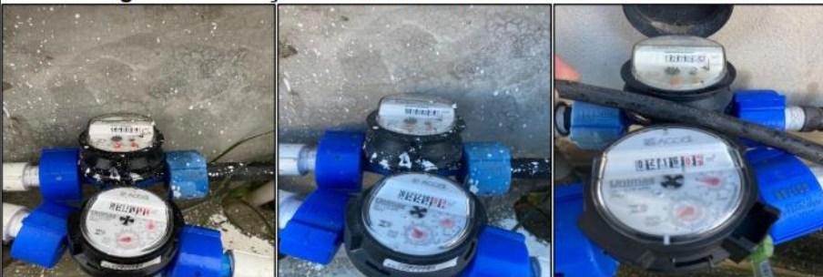
Figura 3 – Aferição de Hidrômetro Rua Machado de Assis
