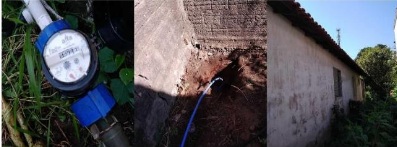
Figura 27 – Conserto De Ramal fora do padrão: Rua Vicente De Cesaro Perito
