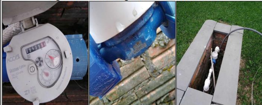
Figura 14 – Falta de Água Rua Doraci Rosa Osório
