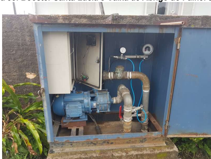
Figura 33: Booster Santa Lúcia e Caixa de Abrigo do Painel e CMB.
