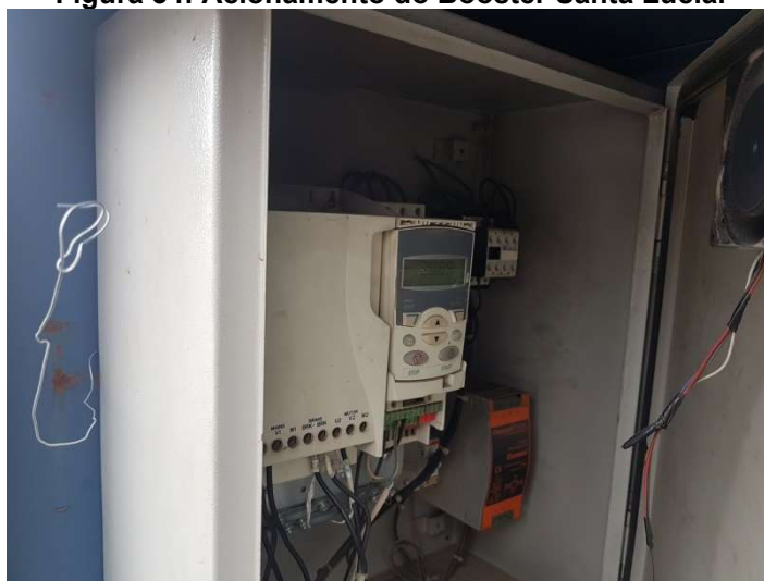
Figura 34: Acionamento do Booster Santa Lúcia.
