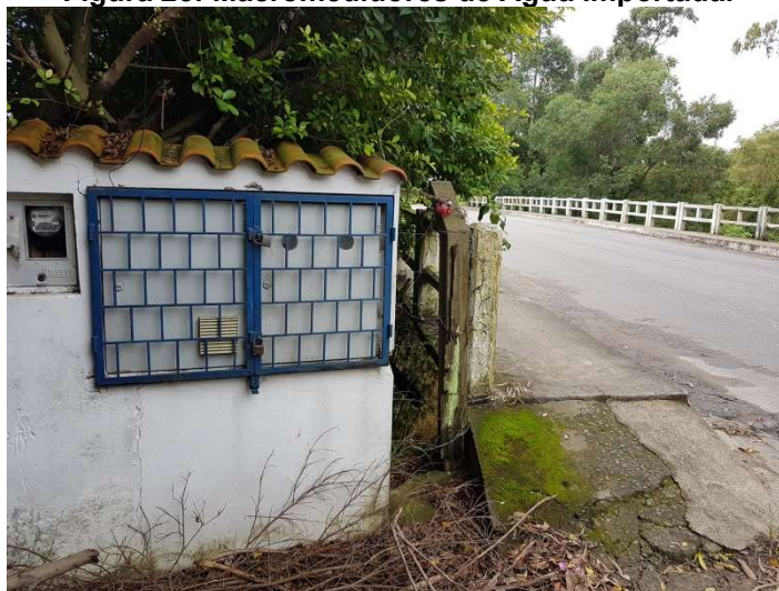
Figura 23: Macromedidores de Água Importada.
