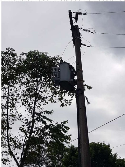
Figura 27: Transformador Instalado no Booster de Entrada.
