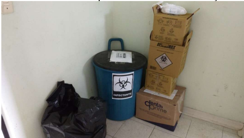
Figura 61: Acondicionamento RSS para coleta na Unid. Central. Condições indevidas.
