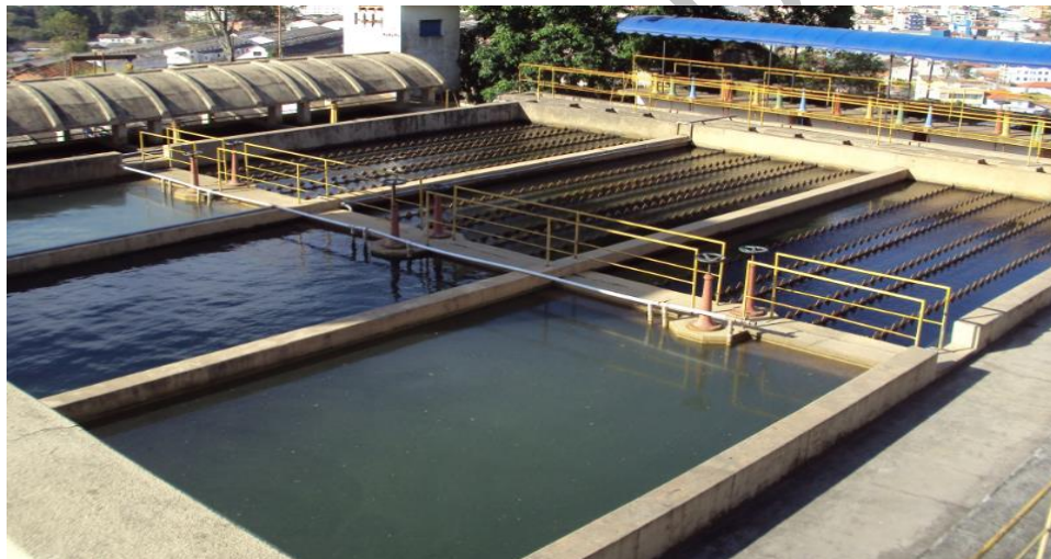
Figura 7: Estação de Tratamento de Água Tubarão – Decantadores convencionais e acelerados
