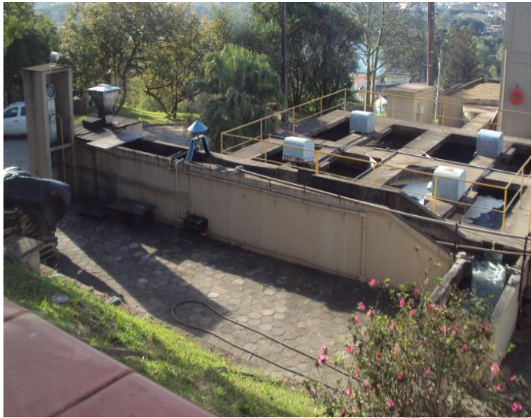
Figura 6: Estação de Tratamento de Água Tubarão – Visão da chegada e flocladores
