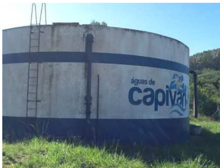
Foto – Reservatórios R-2
